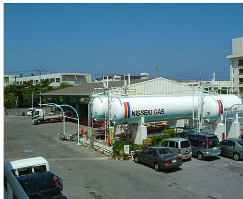
浦添物流センター LPガス充填所
